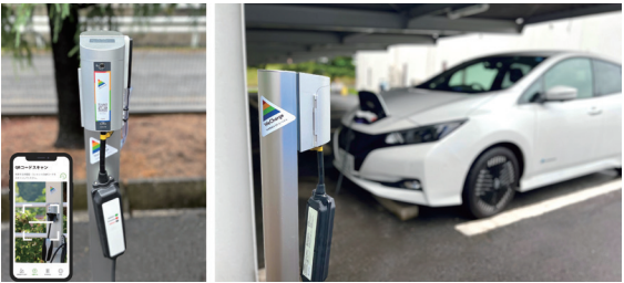
将EV充电智能插头模块（上）安装在EV充电插座内，实现EV充电收费服务
